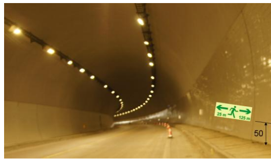
图7 应急通行指引标识安装示例
